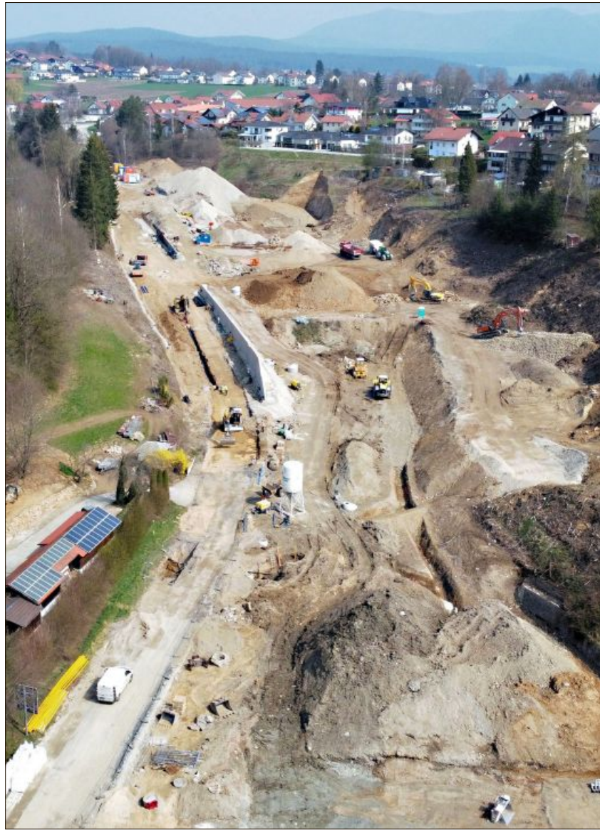
April 2021: Auf einer Länge von knapp 600 Metern wurde die Staatsstraße komplett abgetragen. Fotos: Jürgen Hirtreiter
