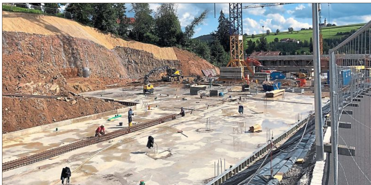
Vollbetrieb auf der Megabaustelle: Der Bau der Grundplatten läuft. Im Hintergrund links die Kokosmatten, die am Hang die darauf liegende Auffüllung sichern.
